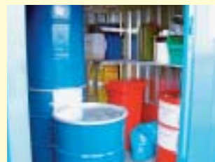
規制化学物質の保管庫底部には、ドイツ国内法で定められた漏洩対策が施されている
