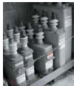
転倒防止のための鎖と漏出防止用の耐腐食性金属の受皿を設置している
