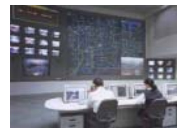
交通/道路管理システム
