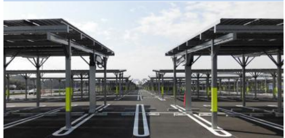
カーポートの屋根の上に設置された太陽光発電システム
