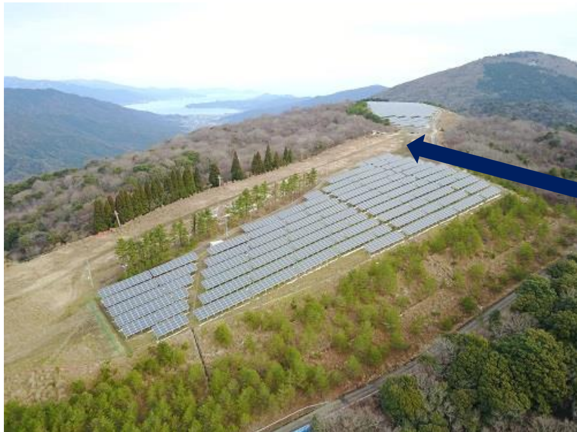
大江山第一・第二太陽光発電所
